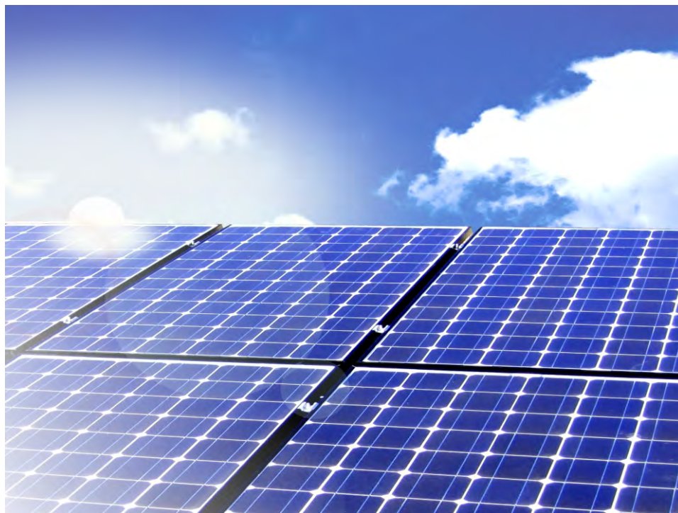
Esempio di pannelli fotovoltaici policristallini montati in copertura.
